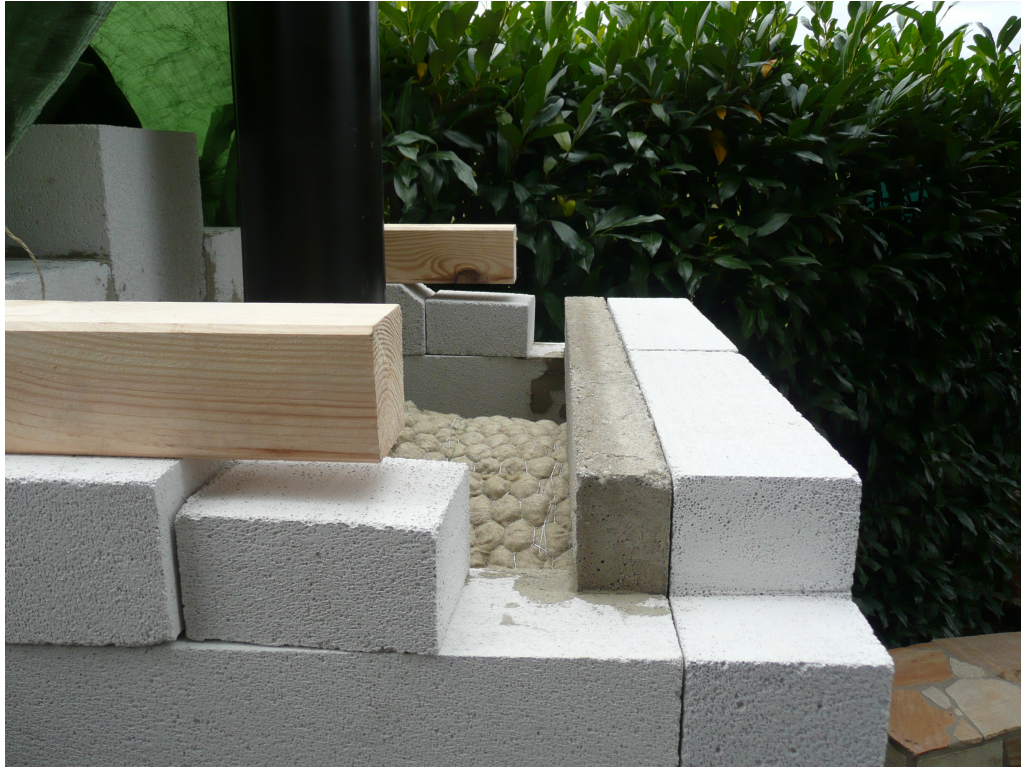
Betonsturz zur Dachauflage (-stabilität!) Isoververkleidung doppelt um Ramster!
